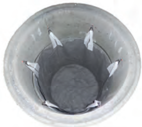
Eingebauter 1-lagiger Filtersack im Schacht DN 1000
