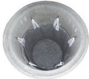
Eingebauter 1-lagiger Filtersack im Schacht DN 1000
